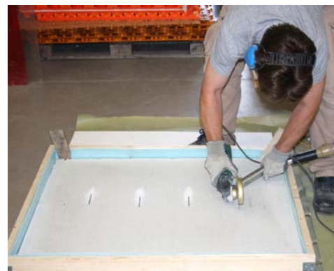
Die Risse werden nicht aufgeweitet. Sie wurden
