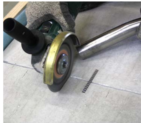
Der Riss wurde mit einer Steinsäge etwa 1,5 cm
