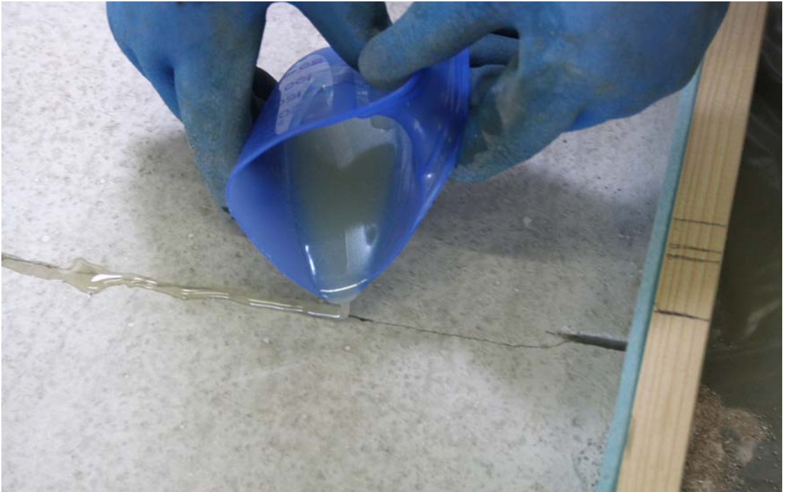
Punktueller Sanieren von Rissen (Rissanierungsart C) führt nicht zum Erfolg.
